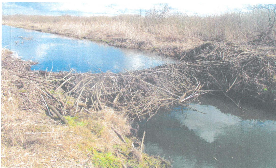
Foto nr 6. Tama wykonana przez bobry Kanał A – 0 w km 1+865
