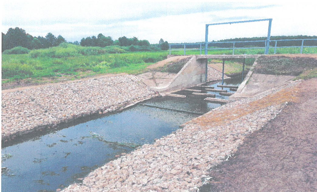
Fot. Nr 4. Jaz żelbetowy na rz. Świnka w km 17+030 m. Albertów, gm. Puchaczów
